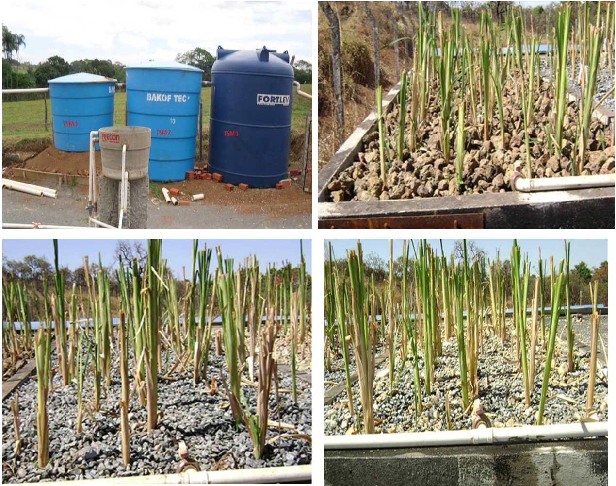
Figura 1 – Tanques sépticos compartimentados, leito com cascalho natural (Leito 1), leito com brita #2 (Leito 2) e leito com cascalho lavado (Leito 3), respectivamente.
